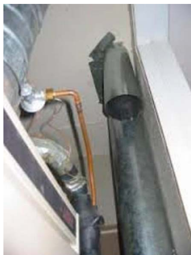
کانال قائم تامین هوای موتورخانه از سقف
