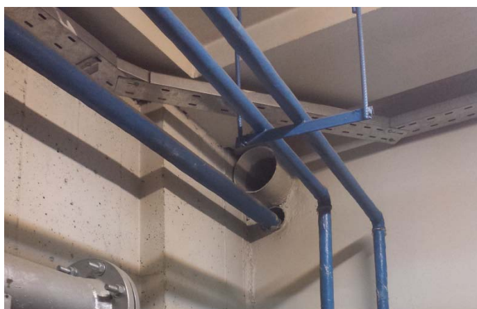
کانال تامین هوای موتورخانه از خارج ساختمان
