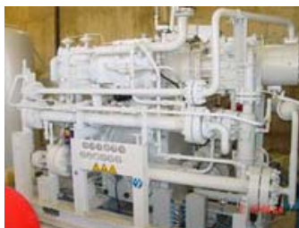
شکل ۳- تصاویری از تاسیسات نصب شده در ایستگاه‌ها
