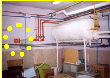
شکل ۱- نمایی از موتورخانه که مجهز به سیستم کنترل هوشمند می باشد.
