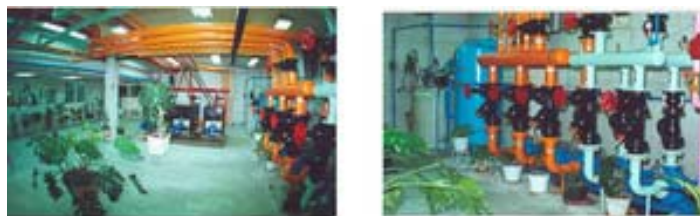
شکل ۱- تصویر یک موتورخانه بعد از بهینه سازی
