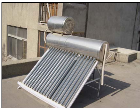
عکس پ ۳-۵۹-۹- آب‌گرم‌کن خورشیدی نصب شده
