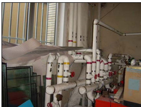
عکس پ ۳-۵۹-۱۰- عایق کاری مناسب لوله‌های سیستم گرمایش مرکزی ساختمان
